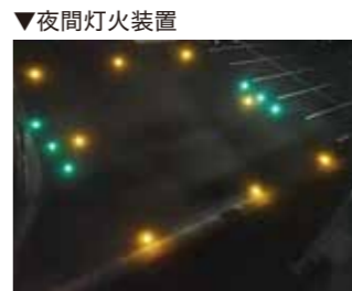
▼夜間灯火装置
