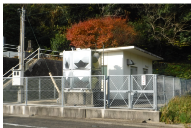
船木送水ポンプ場
