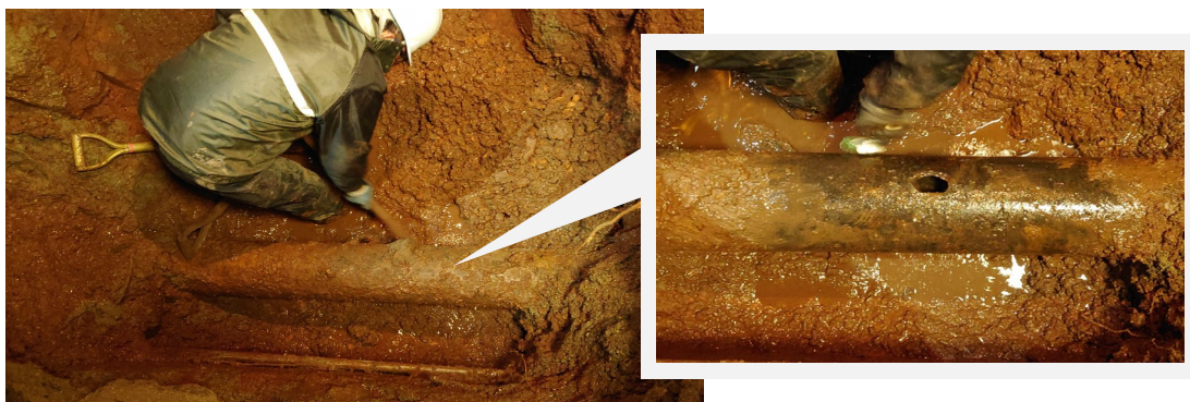
送水管（φ200）の破損状況
