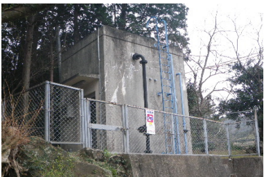
大野中継ポンプ場
