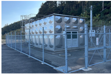
水垂中継ポンプ場
