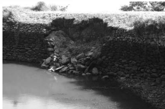
▲被災した溜め池
