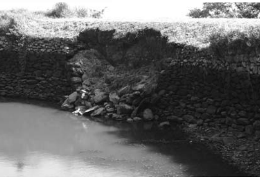
▲被災した溜め池
