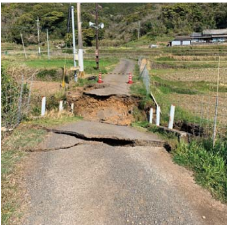
▲被災直後の大切橋
