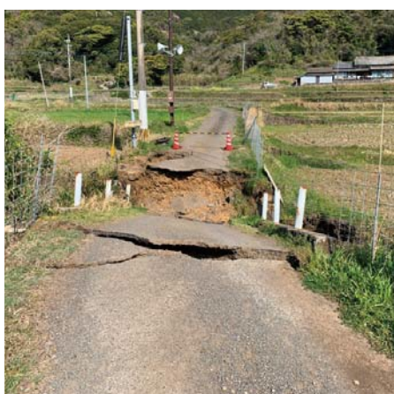
▲被災直後の大切橋
