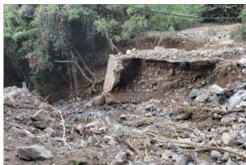
高越地区の崩れた橋梁
