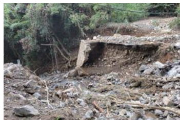
高越地区の崩れた橋梁
