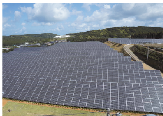
太陽光発電所（田平町）
